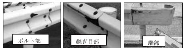
写真-1 防護柵に付着した金属片
