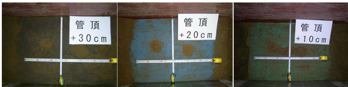
写真8 caseH (管周方向・山砂・地下水位80cm)のゆるみ・空洞進行状況
