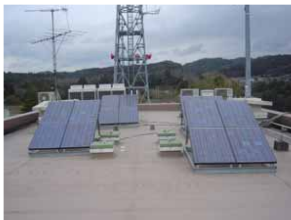
写真1 太陽電池設置状況
