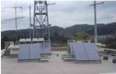
写真 15 太陽電池（管理事務所屋上設置）
