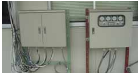
写真 16 電力制御装置
