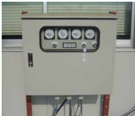
写真3 電力制御装置
