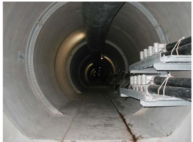
(2005 年 3 月 30 日撮影) 写真-27 関西電力江戸町洞道
