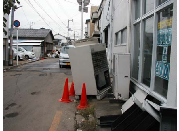
2004 年 9 月 1 日，福岡町 4 丁目にて撮影 写真-13 浸水して故障した空調室外機
