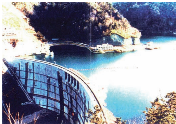
写真 2.1 堤体下流面の漏水状況（昭和 56 年対策以前）
