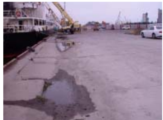
写真-4 エプロンのわだち掘れ (A 4 港)
