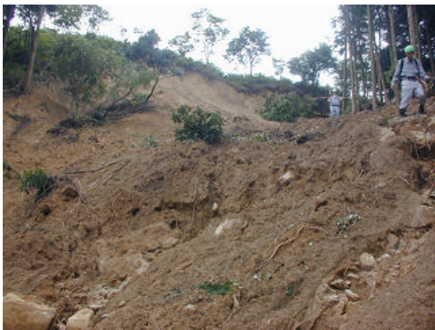
写真-3 本川崩壊源頭部
