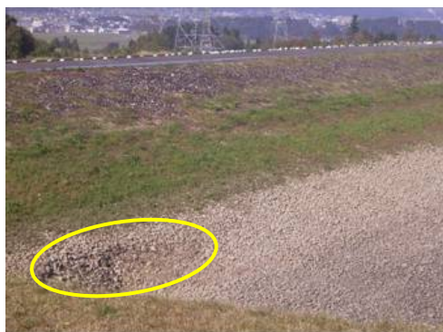
写真 8.7 貯水池側のり面リップラップの段差 (新山本調整池)
