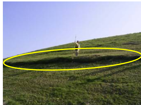
写真 8.8 貯水池外側のり面のはらみだし部 (新山本調整池)
