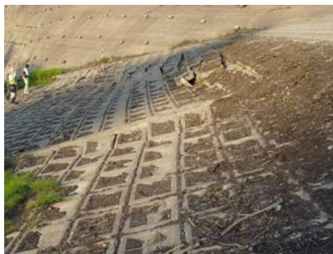
写真 8.15 上流のり面の変状（川西ダム）
