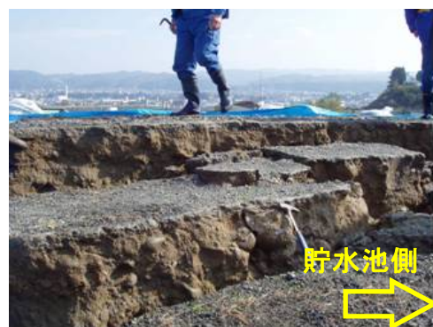
写真 8.2 天端亀裂による段差 (浅河原調整池)
