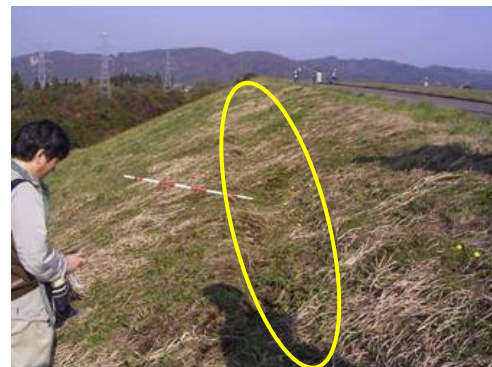
写真 8.6 貯水池外側のり面陥没および亀裂 (新山本調整池)
