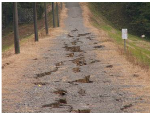
写真 8.1 天端亀裂近景 (浅河原調整池)
