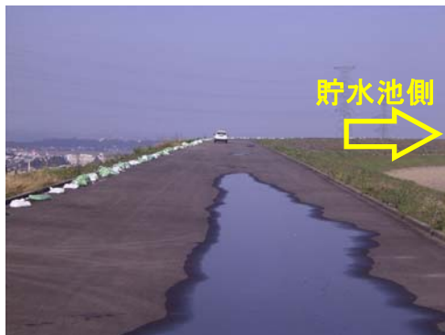
写真 8.5 天端舗装面の傾斜 (新山本調整池)
