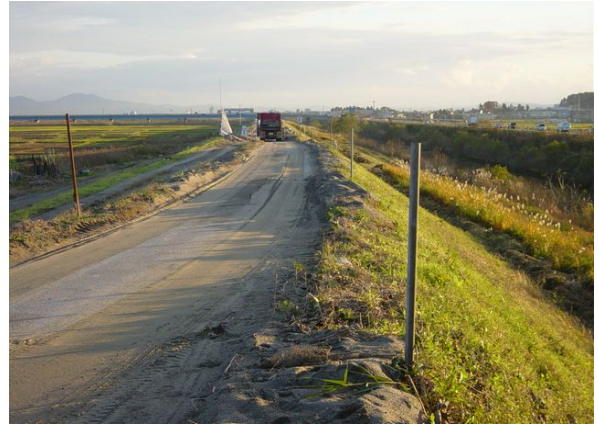
(a) のり肩を残して天端が沈下
