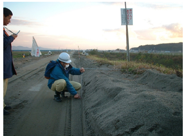
(b) のり肩と天端の段差
