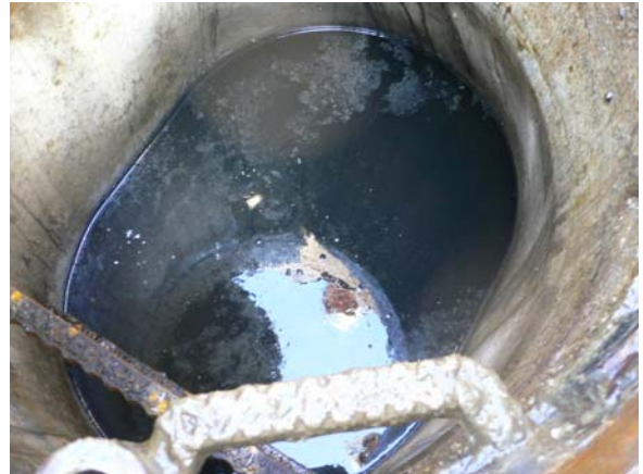
写真 6.8 マンホール内の滞水状況 (堀之内町)
