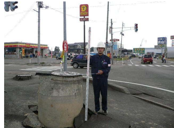
写真 6.4 マンホールの浮上がり (小千谷市)
