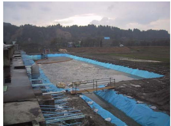
写真 6.10 仮設沈殿池 (堀之内浄化センター)
