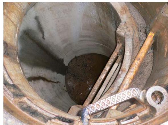
写真 6.6 マンホールの躯体のズレ (堀之内町)
