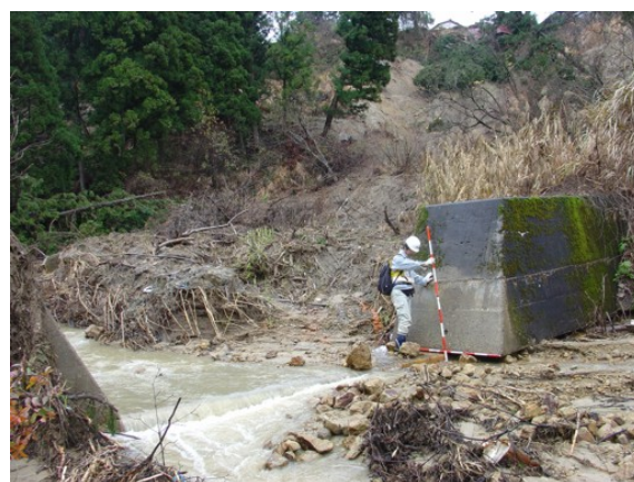
写真 5. 28 左袖が破損した神沢川第一砂防えん堤
