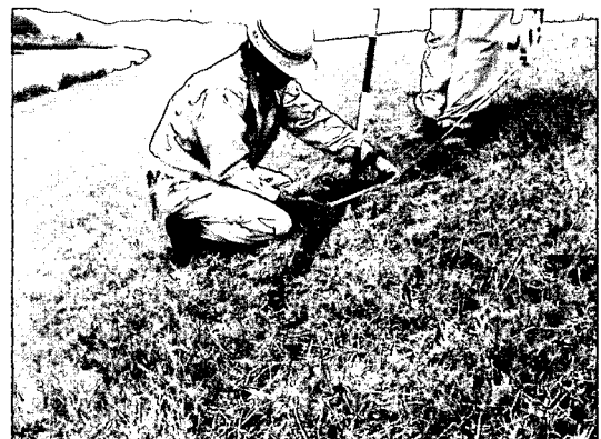
写真5. 12 被災直後の釜谷地区、堤防法面にクラック(北上川左岸0.8k~1.4k)
