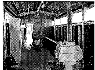
開閉機構-左岸側
