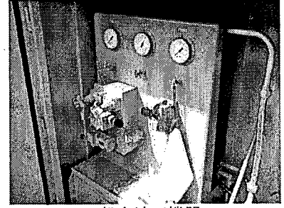
盤内油圧機器
