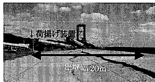
図-1 岸壁の沈下の状況
