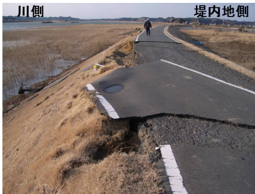
写真-3.2.2.2 堤防天端アスファルト舗装の剥離状況 (鳴瀬川左岸 1kp 付近)
