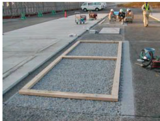
写真-4.2.17 テストピットその 2 の型枠放置状況
