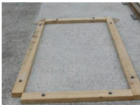
写真-4.2.14 テストピットその 1 の型枠放置状況
