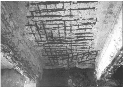
図 2-21 劣化度Ⅲ～Ⅴの状況
