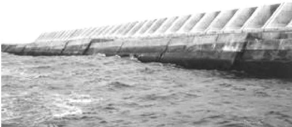
図 2-5 防波堤の沈下
