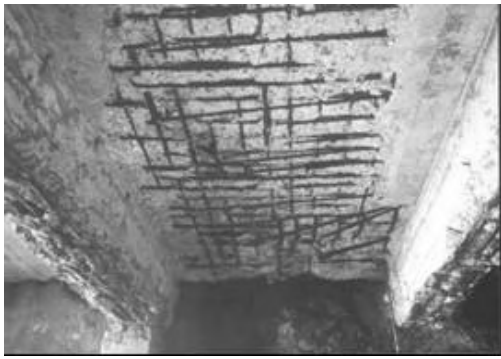
図 2-8① 上部工 床版下面の劣化状況
