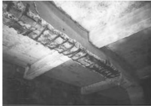
図 2-8② 上部工 梁下面の劣化状況
