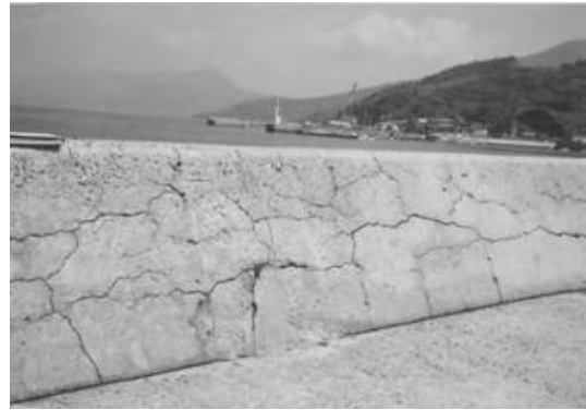
図 2-2 護岸胸壁の損傷
