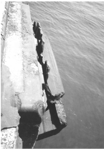
図 2-3 防舷材の損傷
