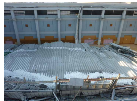
写真 体育館の屋根崩落
