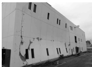
津波による建物被害
