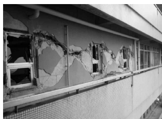
非構造壁の被害
