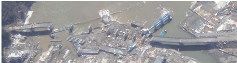
上部構造の一部径間が流出した橋(写真提供：東北地方整備局)
