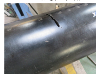
図-2 模擬損傷ケース
