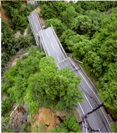
【写真 2】崩落した祭時大橋
