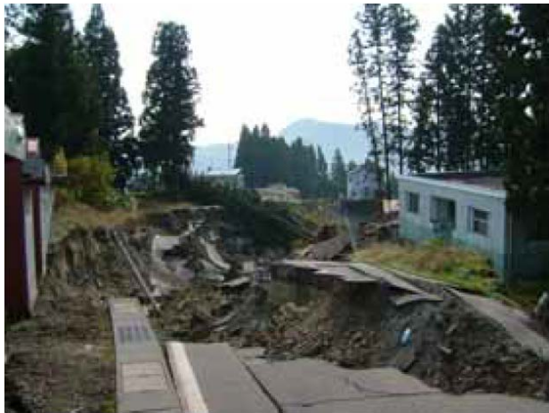
【写真】地震で崩落した道路
