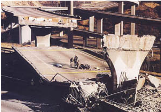
【写真 2】高架橋の損壊
