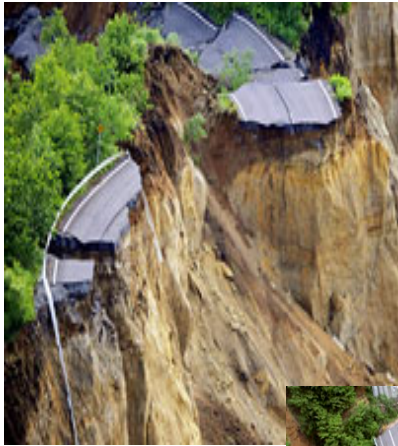
【写真 1】 地震で崩落した道路
