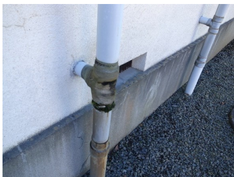
写真Ⅱ.3.21 雑排水管の劣化状況
