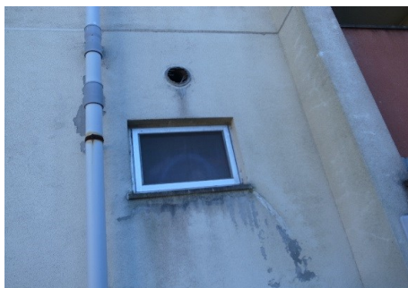
写真Ⅱ.3.23 雑排水管の劣化状況
