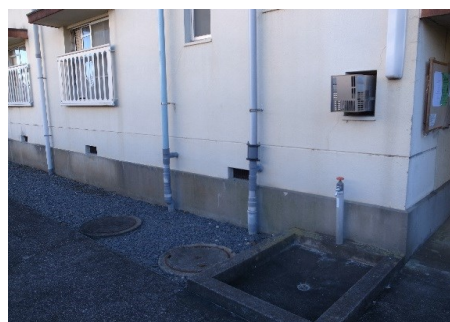
写真Ⅱ.3.24 雑排水管の劣化状況
