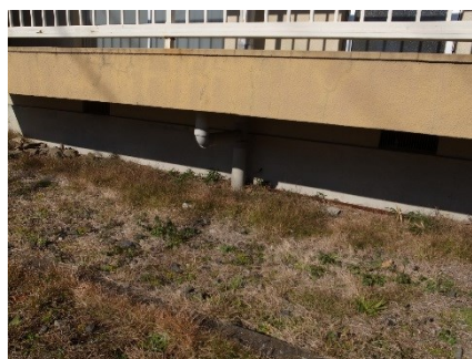
写真Ⅱ.3.10 住棟足回りの雑排水管
