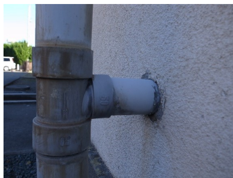
写真Ⅱ.3.22 雑排水管の劣化状況
