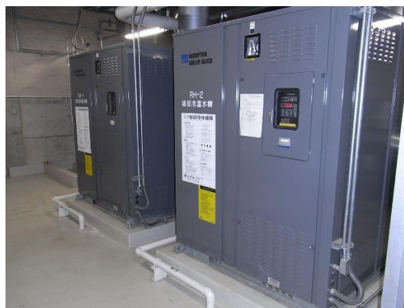
図3.3.2 冷温水発生機
