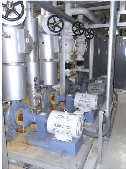
図3.3.3 冷温水・冷却水ポンプ
