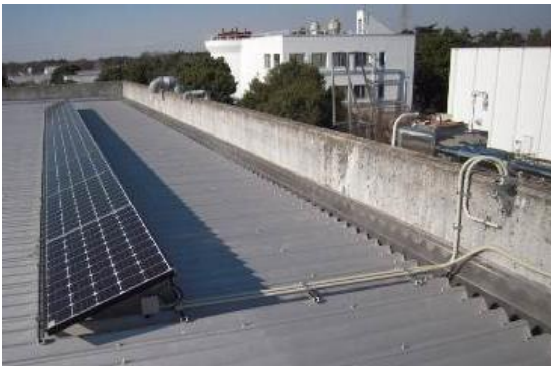
写真 5－5 太陽光発電装置の設置状況（既設）
