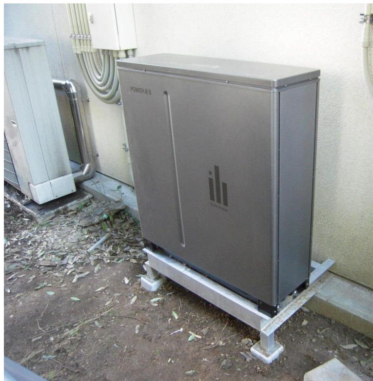
写真 5－4 蓄電装置の設置状況
