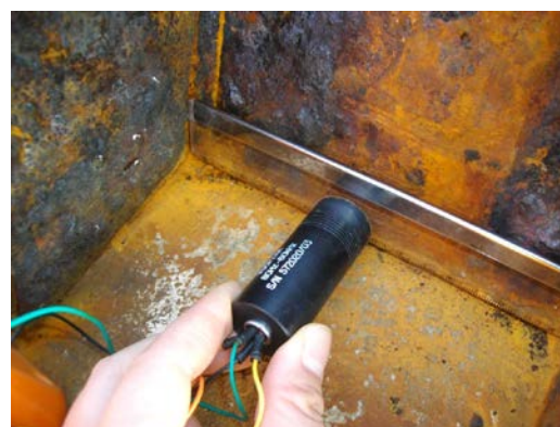
図-2. 2. 137 腐食検出確認 (下部)
