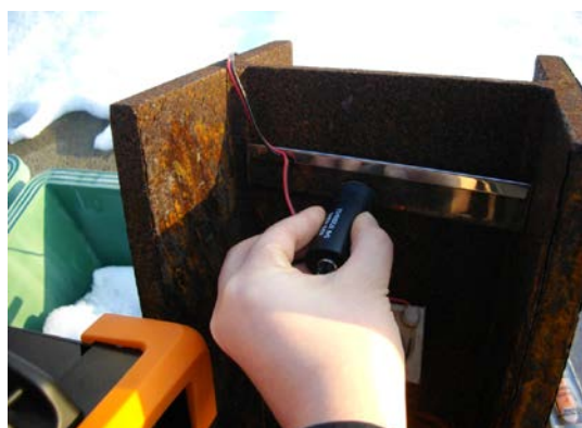
図-2. 2. 136 腐食検出確認 (上部)
