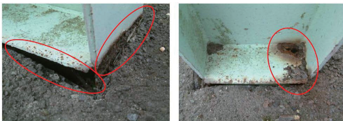
図-2.1.3 筒井大橋 トラス斜材コンクリート埋め込み部の腐食損傷
