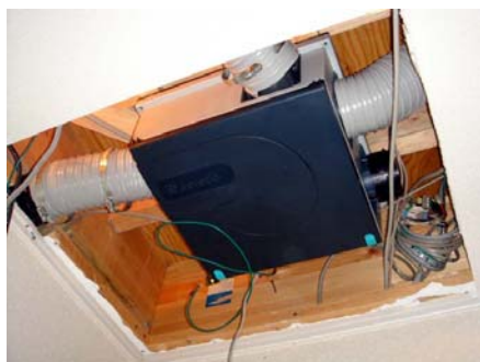
写真2.4.1 ファン本体設置状況
