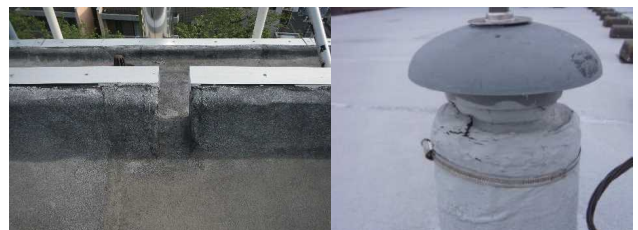
図1 防水上の納まりの不良(左:水切り穴の寸法が不適当な事例、右:通気管に水切りが無い事例)
