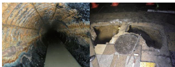
図-2 下水管の腐食（左）と歩道の陥没（右）
