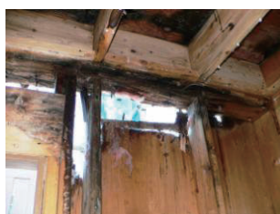
写真1 耐力壁の劣化状況
