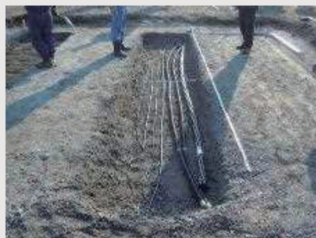
写真1 埋設したケーブル損傷等の検証
