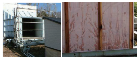
写真2 撒水試験による漏水状況
