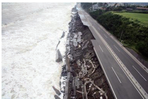
写真 平成19年西湘バイパスの被災 （関東地方整備局横浜河川国道事務所HPより）
