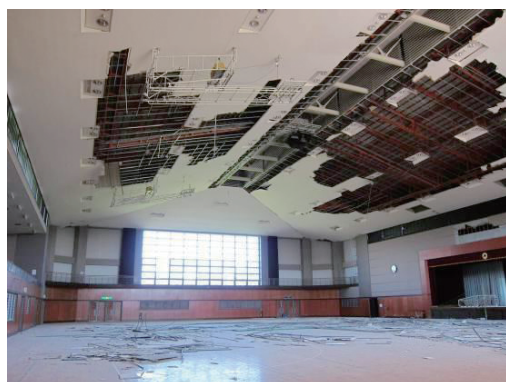
写真 体育館における天井脱落被害の例
