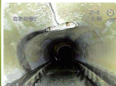
写真2 塩ビ管の破損事例
