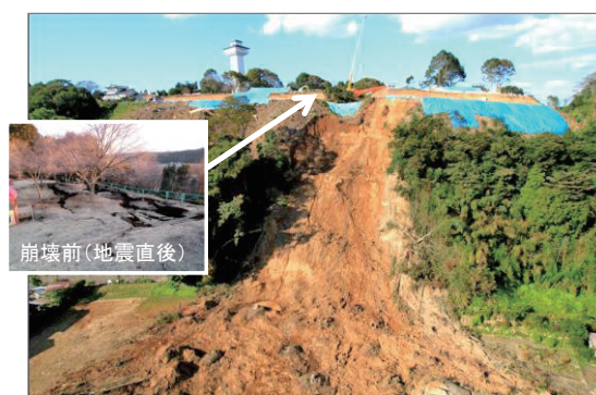
写真1 東北地方太平洋沖地震後の降雨で崩壊した斜面の例(栃木県砂防課提供)
