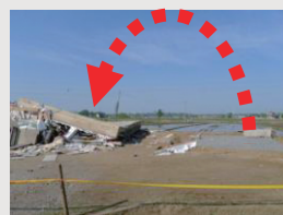
写真-1 転倒した住宅
