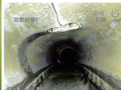
写真2 塩ビ管の破損事例
