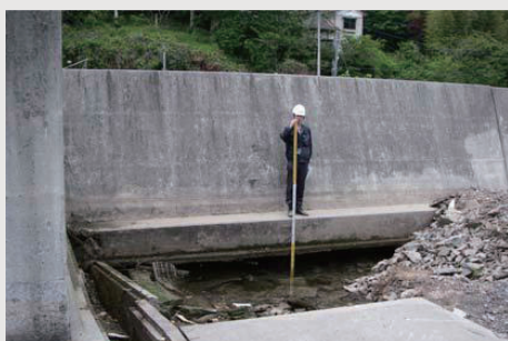
写真 現地調査状況(基礎部の吸出し)
