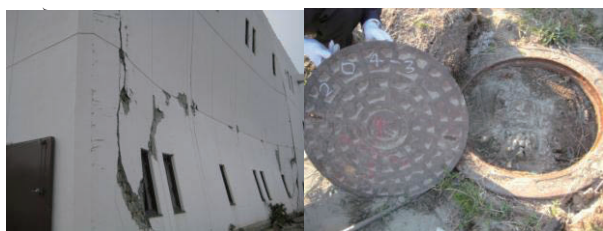
図1 下水道施設の被害状況
