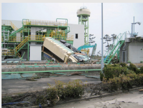
仙台市南蒲生浄化センターの被災状況
