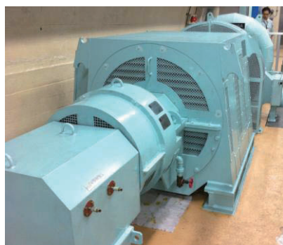
写真1 管理用発電設備（寒河江ダム）
