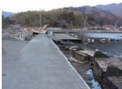
写真1 防潮堤の被災状況 (引き波によるもの)
