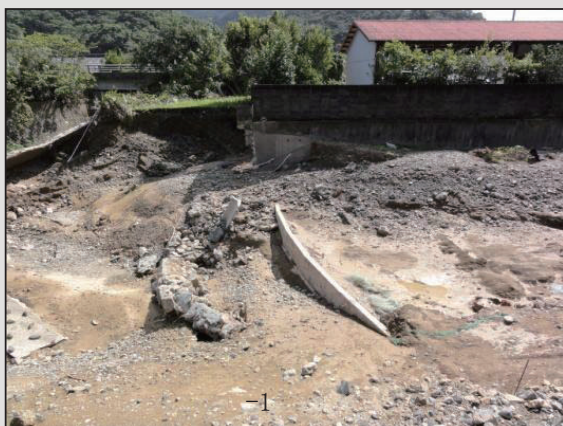
写真-1 住用川・冷川の堤防決壊箇所
