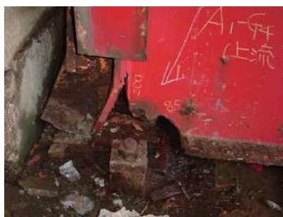
写真-1 局部的に腐食した主げた桁端の例
