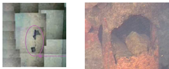
写真-1 矢板損傷状況 写真-2 矢板損傷状況
