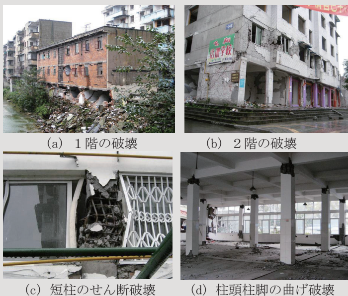
図-2 建築物の被害状況
