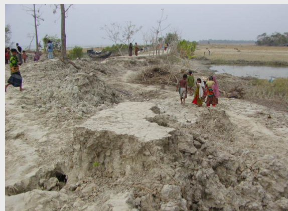
写真-1 侵食された堤防
