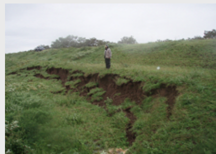
写真-2 米代川左岸7.8kmの堤防滑り
