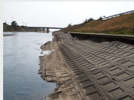
写真-1 八ヶ川右岸護岸法崩れ
