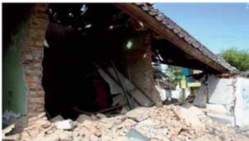
ジャワ島中部地震における組積造建築物の被害
