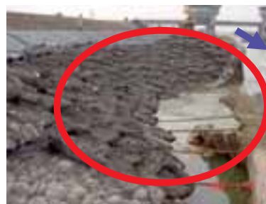
図－1 低水護岸の変状例（2006年3月）
