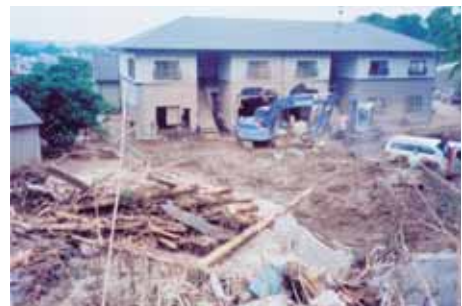
写真-1 福岡県太宰府市三条一丁目被災状況
