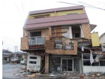
2階が崩壊した鉄骨造建築物
