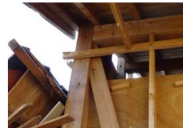
木造筋かい接合部に金物無し
