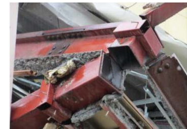
鉄骨造建築物の溶接部の破断
