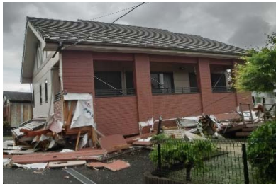
1階が倒壊した木造住宅
