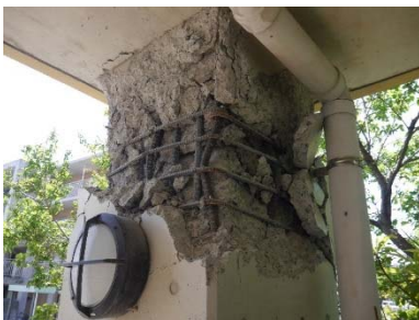
RC造建築物(ピロティ柱)の大破
