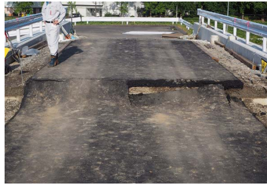
実験後の段差の様子 (左側補強材あり)
