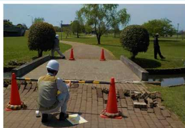
↑ 公園施設の被害調査と立入禁止措置(熊本市※)
