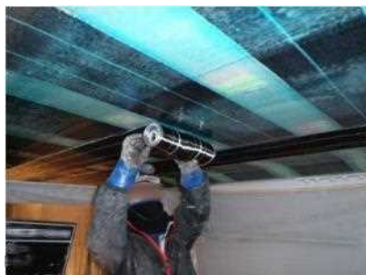
炭素繊維シート接着状況
