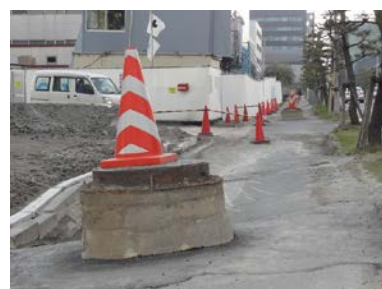
液状化によるマンホールの浮き上り
