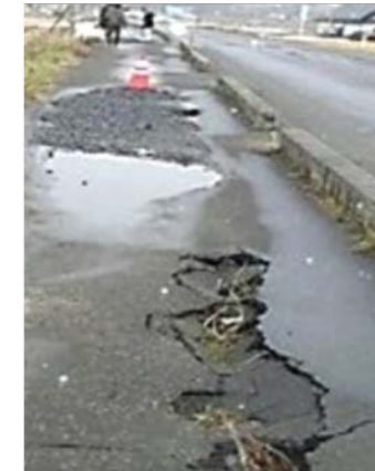
無対策箇所(被害大)
