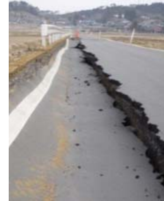
無対策箇所(被害大)
