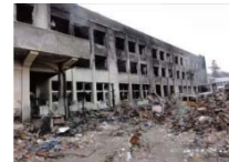
地震火災被害建物の一例
