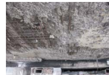
火災後の構造体の被害例
