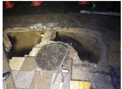
下水道起因道路陥没の事例
